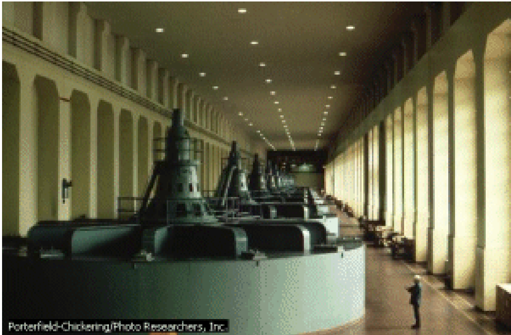
Figura – Gerador de energia em uma hidrelétrica.
